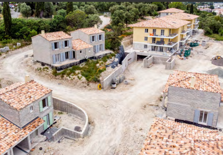
Construction d'un ensemble de 40 logements et de 10 villas à Grasse (06) Parc de l'Oliveraie en 2020 - 1 960 000 €
